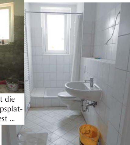
... ein schickes Bad ist entstanden, es fehlen nur noch Rest- und Reinigungsarbeiten
