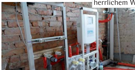
Das alte Bad wurde entkernt und die Rohmontage der Vorwandinstallation steht bereits ...
